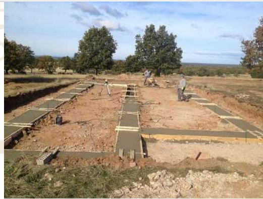
Fig. 1.46. ARREVOL, & Romero Alonso, R. J. (2018, verano). Cimentación en terreno llano con buena resistencia. [Foto cimentación]. ARREVOL. https://www.arrevol.com/blog/5-factores-a-tener-en-cuenta-para-elegir-la-parcela-donde-construir-tu-casa-vivienda
